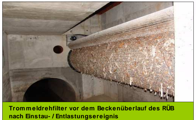
Neue Einleitung in den Kursee vor dem Kurhaus für Entlastungen des RÜB 65
